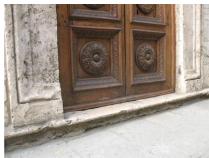
Fig. 4: Particolare dell'ingresso Nobile Collegio del Cambio con gradino
